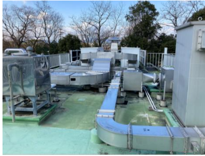
図2 屋上の排気ダクト
