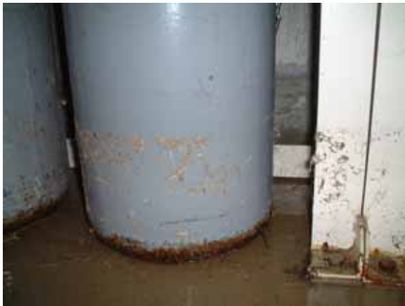
写真3 ガスボンベの腐食
