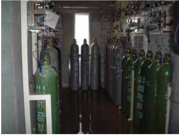
写真1 高圧ガス容器置場
