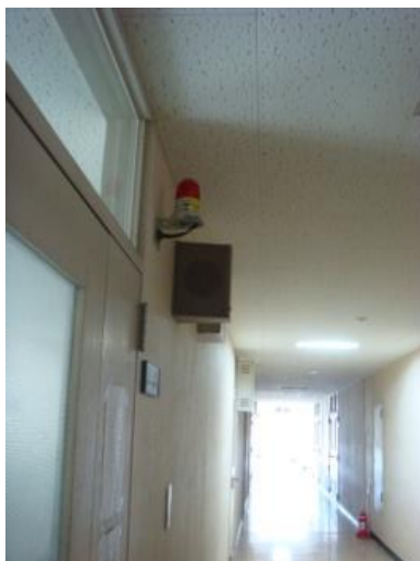
写真3 COガス警告灯
