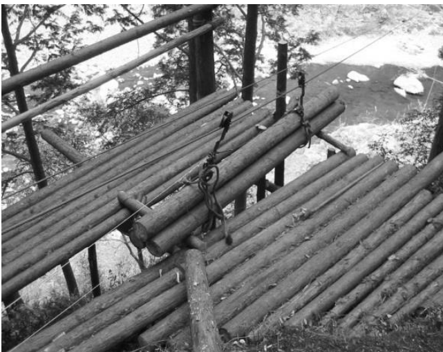
(写真2) 積込み盤台 (先柱)
