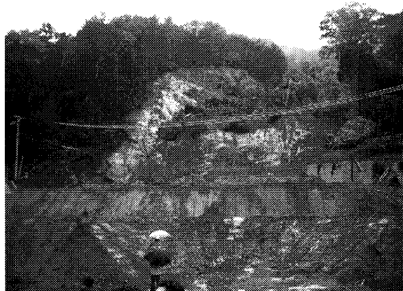
写真3 滝谷地区の斜面崩壊と堆積土砂
