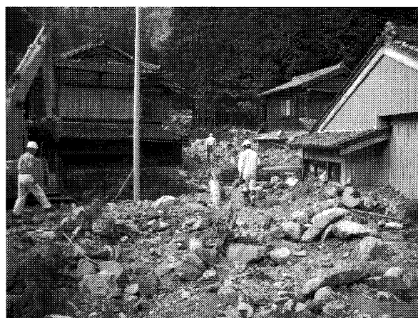
写真4 久豆地区の土砂流出と集落被害
