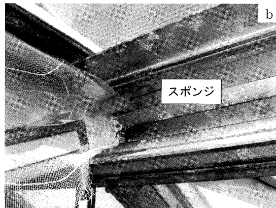
第6図 天窓からの逃亡箇所
