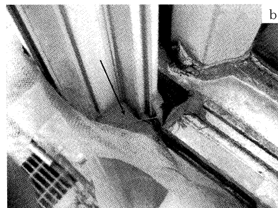
第5図 側窓からの逃亡箇所 a: 内側クリップ留め方式. 窓枠上部角の隙間. b: 窓枠・框固定方式. 窓枠上部角の隙間(シリコンコーキング材充填後を示す).
