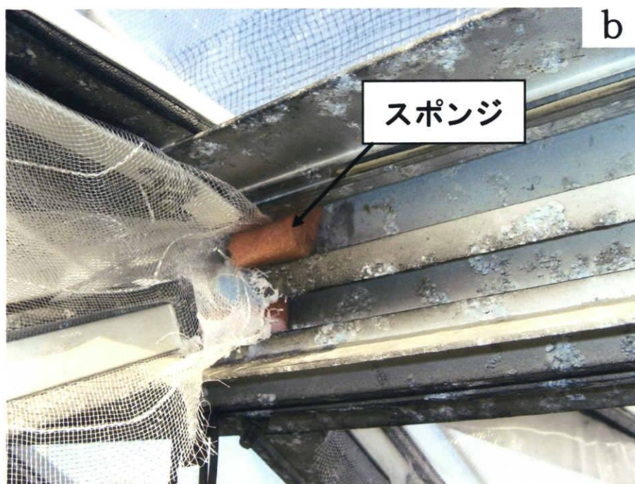
第8図 天窓からの逃亡箇所
