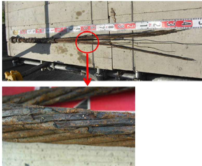
図-2.23 破断したアンカーの引張り材の腐食状況 28)
