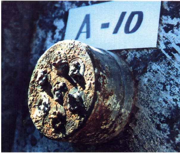
(a)腐食によるアンカー頭部の劣化 (昭和63年調査時点)
