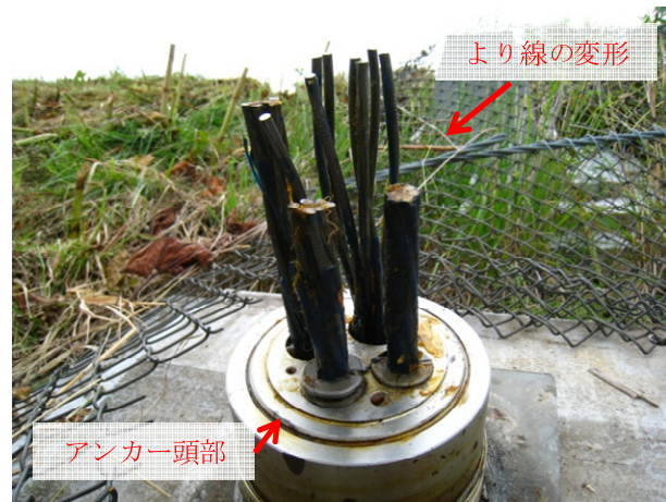
(b) より線の変形したアンカー
