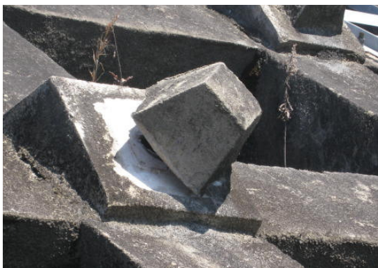
(a)浮き上がり
