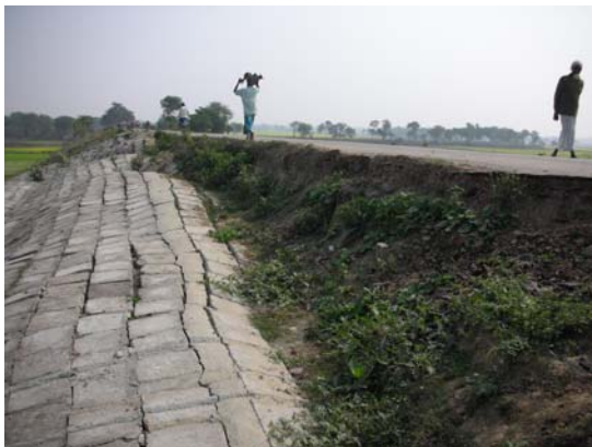
図2。ゴダガリ地区の盛土堤防の崩壊
