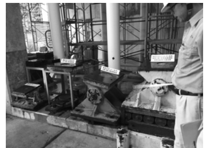
(f) 鋼製・ゴム支承劣化
