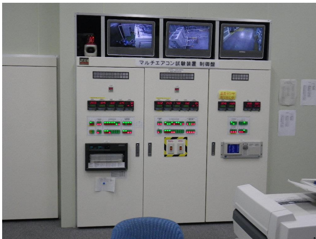
図 2.8 「ヒーポンらぼウエスト」の制御操作盤
