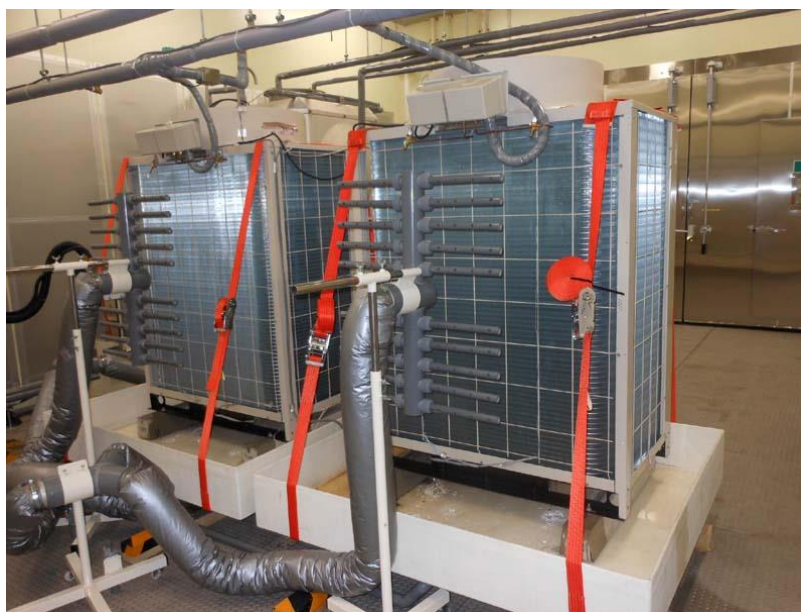
(a) 直接式水噴霧装置
