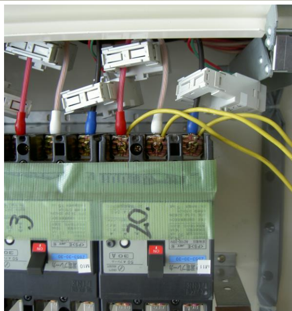
図 3.4 各 EHP のブレーカーに接続された電力量計
