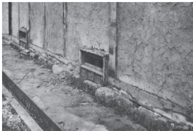
図5 昭和補修 補修前土台廻り腐朽の様子(昭和41年)
