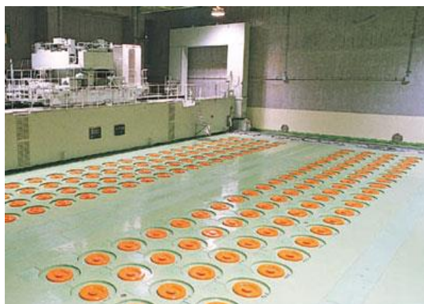
写真：ガラス固化体の貯蔵施設
