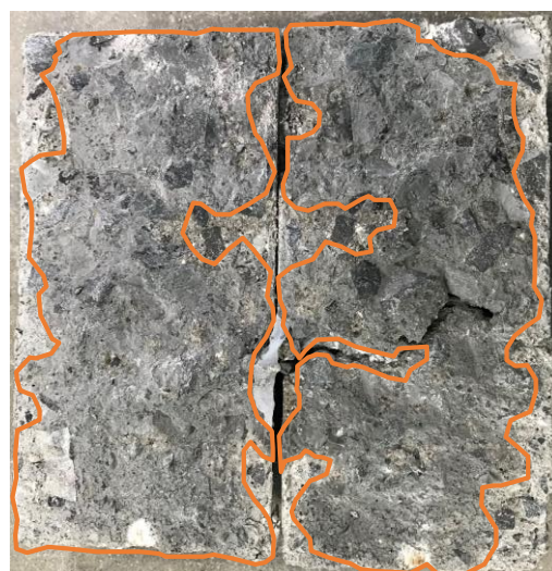
写真-4.2 ひび割れ幅 0.4mm
