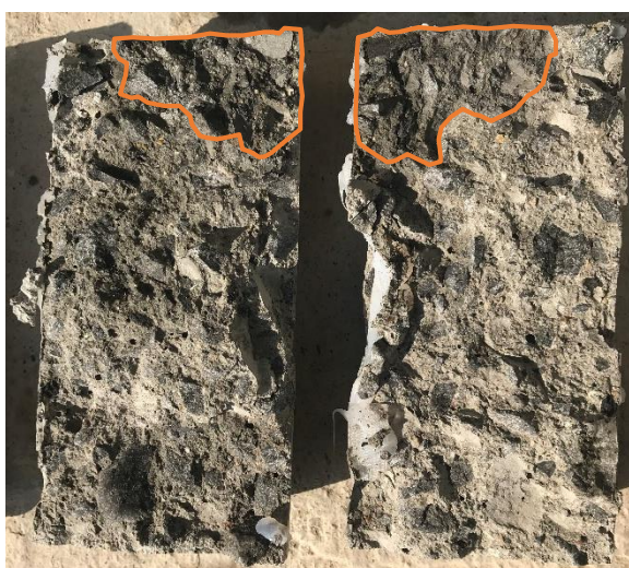
写真-4.1 ひび割れ幅 0.2mm
