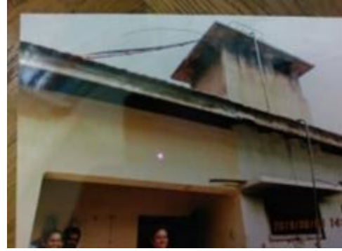
写真 1-4 屋上の貯水槽
