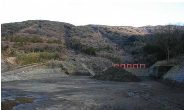
図-2 一般的な流木捕捉施設は遊砂池等の大規模施設と共に設置される（大金沢、2013年の伊豆大島土砂災害後撮影）
