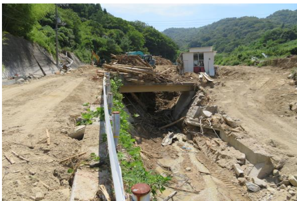
図-1 橋梁が流木と土砂によって閉塞し、氾濫が生じた場所（2018年7月の西日本豪雨、広島県坂町総頭川にて撮影）
