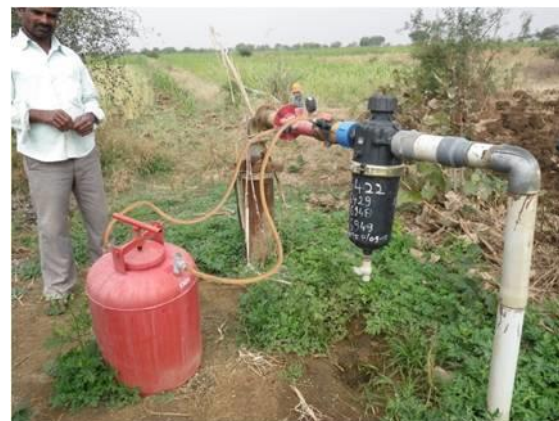
写真8 液肥も同時に施用できる灌漑設備
