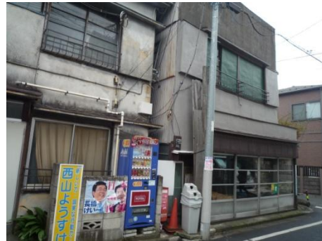
写真 5-2-4 老朽化した木造建築物
