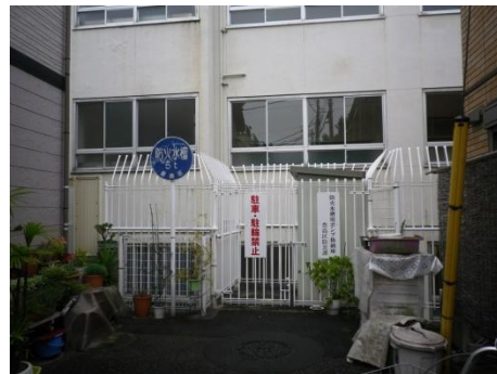
写真 5-2-6 防火水槽(池袋中学校敷地に設置)
