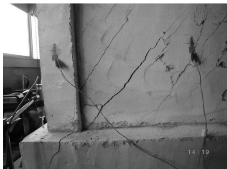
写真 2.3.5 ひび割れ性状 (Fc21W-2) 19)
