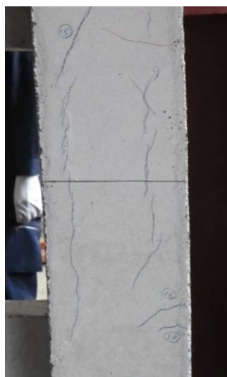
写真 3. 3. 10 (柱の主筋に沿った付着ひび割れ)
