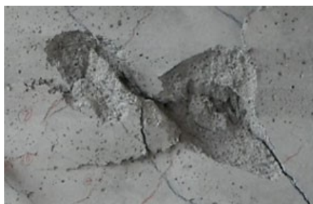
写真 3.3.1 (壁板の圧壊・剥離)
