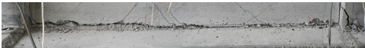
写真 3.3.5 (壁板および側柱と下梁境界部のスリップ破壊)
