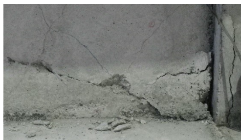
写真 3.3.2 (壁板隅部の圧壊)
