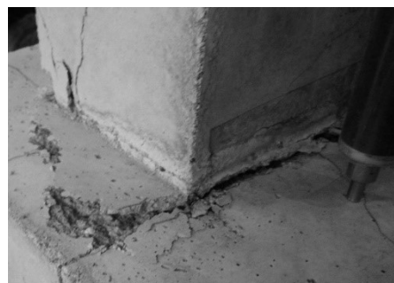
写真 3.3.4 (柱脚部の引き抜き)
