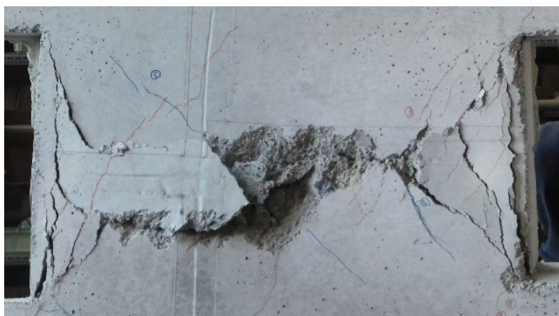
写真 3. 3. 11 (複数のせん断ひび割れ)
