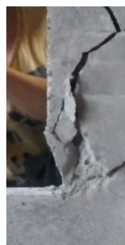
写真 3.3.9 (開口端部の圧壊・剥離)
