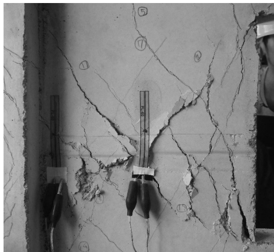
写真 3.3.6 (複数のせん断ひび割れ)
