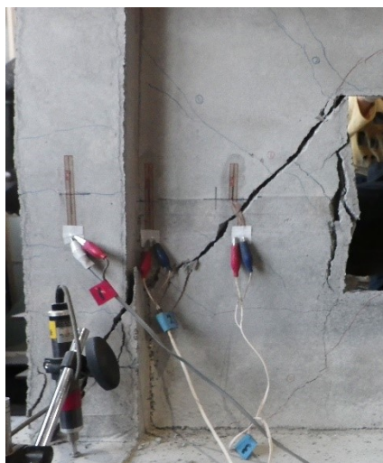
写真 3.3.8 (1本の大きなせん断ひび割れ)
