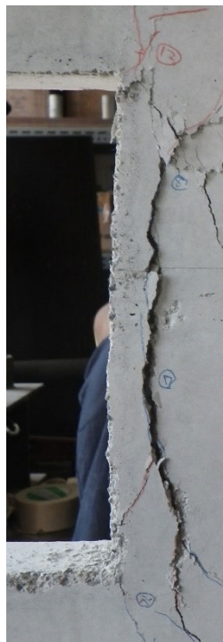
写真 3.3.7 (補強筋に沿った付着ひび割れ)
