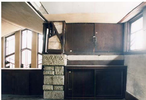
写真4-2 中央棟FLライトミニミュージアム 柱壁が外側に傾いている
