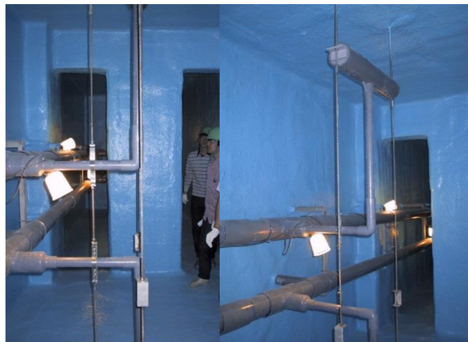
写真 1.1 平型の連結型水蓄熱槽
